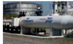
Іл. 43.11. Нафтоперекачувальна станція (Одеса – Броди)
